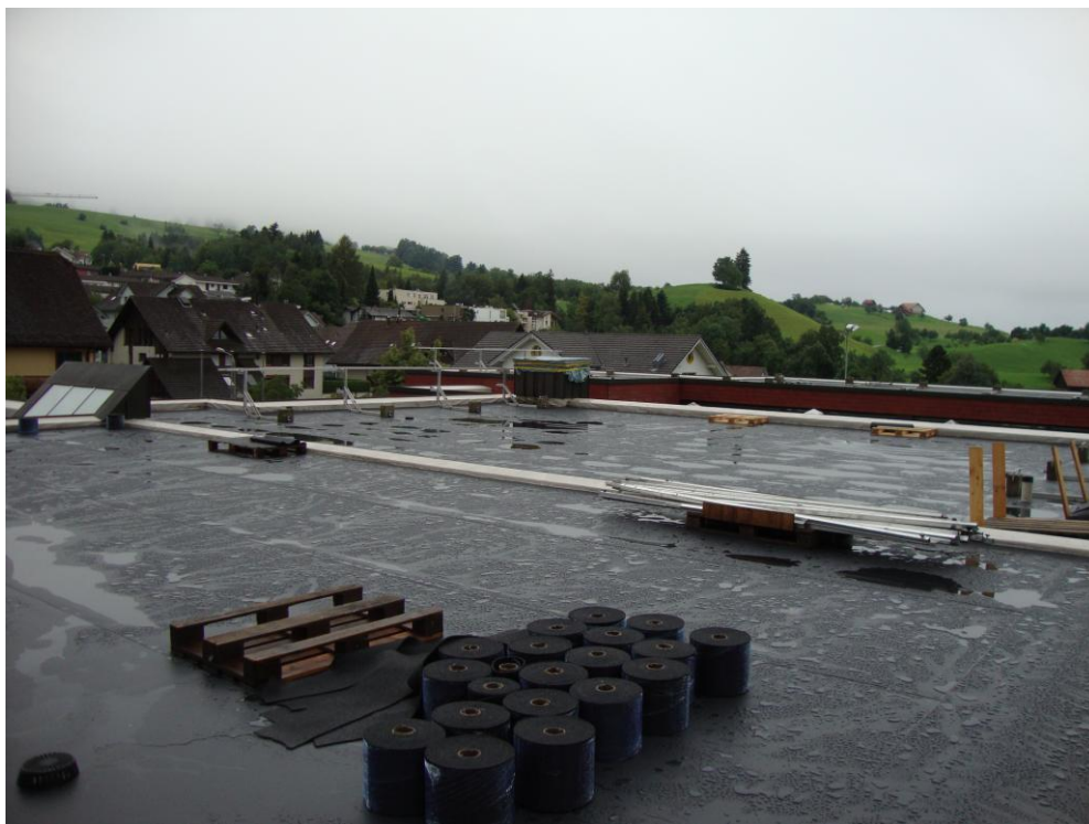
So, jetzt ist das Dach vorbereitet für die Montage der Unterkonstruktion der PV-Anlage. Die Gummischrotmatten für die Auflage der UK liegen auch bereit.
