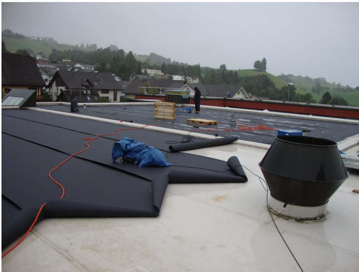
Das Dach wird gereinigt. Anschliessend wird das neue Schutzflies verlegt und verschweisst. Das Wetter meint es gar nicht gut.
