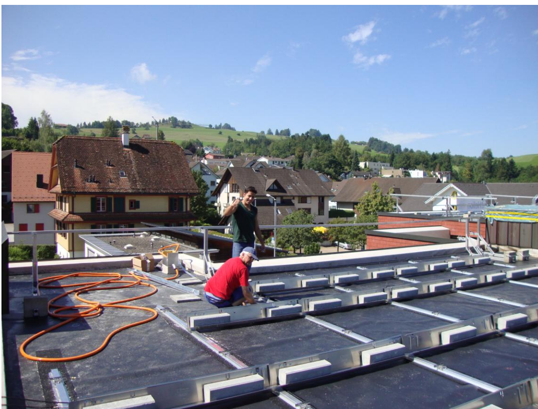
Die Dachdurchführung wurde auch erstellt und das Zuleitungskabel für die PV Anlage liegt bereits auf dem Dach.
