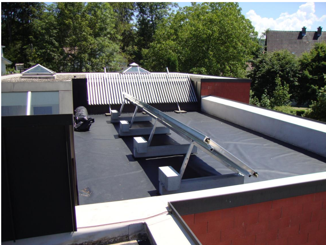
Hier wurde auch bereits die Solaranlage der Gemeinde für die Warmwasseraufbereitung aufgestellt.
